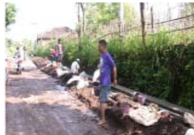
Gambar 2. Saat Pelaksanaan Saluran Drainase Jalan Desa ( Tampak Jalan Desa yang Rusak Akibat Seringnya Terendam Banjir )
