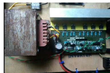
Fig. 6. DC – AC Inverter
