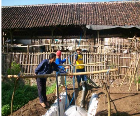
Instalasi Biogas Telah Terpasang dan dalam Proses Pengisian Slurry Sambil menunggu Produksi Biogas
