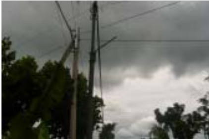
Gambar 5. Jaringan instalasi transmisi menengah 20 KV dan tegangan rendah 220 V di tengah Desa Genukwatu.
