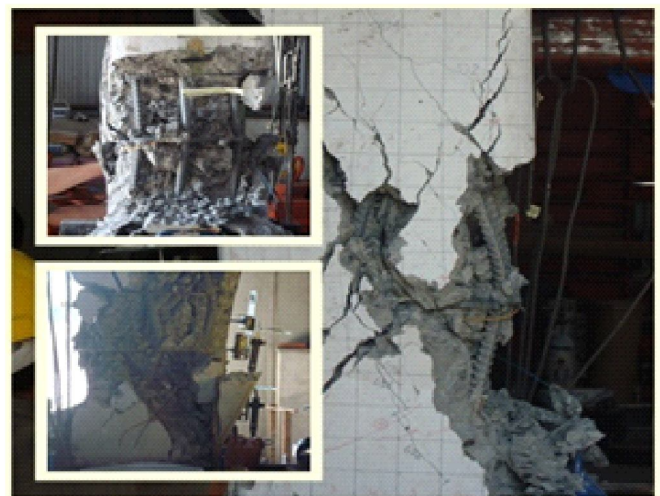
Gambar 11. Kegagalan Kolom C-1
