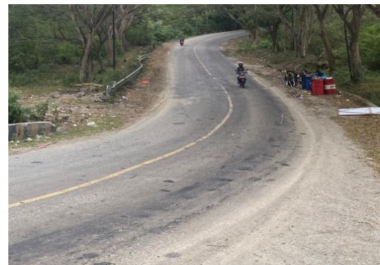
Gambar 3. Kondisi Eksisting Ruas Jalan Tanjakan Ganti STA 1+950 - 2+025 Km
